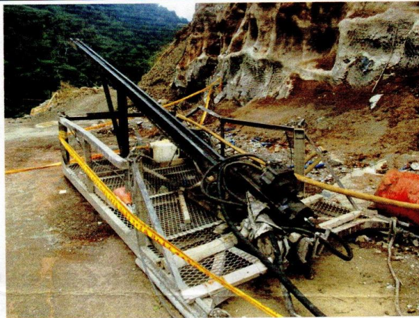
照片說明：發生災害之搭乘設備。
